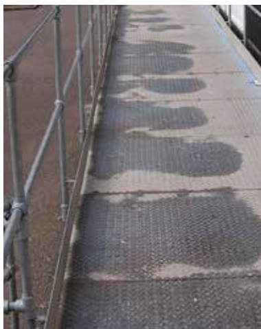
Rampa de acero pulida antes del recubrimiento
